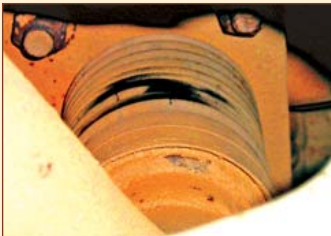
Рисунок 19. Скопление сажи на гофре выхлопной системы указывает на наличие трещины
